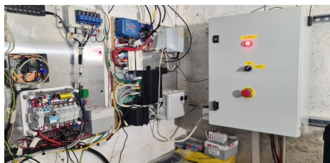
Toute la partie logique du relai a été rénovée par Erick F4GSP
