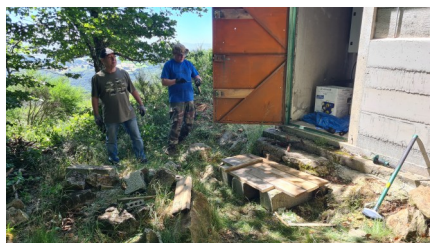
Amenagement devant le local énergie
