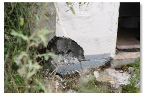
Sous la puissance de la foudre le bâti n'a pas résisté
